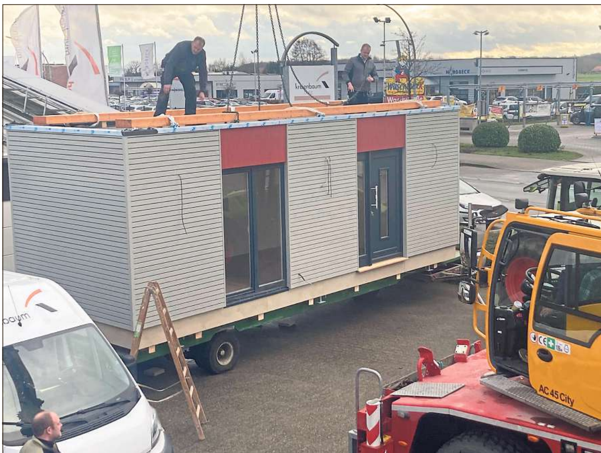
Mit einem Kran wird das KH-Modul der Firma Kreienbaum Holz aufgesetzt, nachdem es im ortsansässigen Werk vorproduziert wurde. Fotos: Kleinemeier (2), Kreienbaum Holz (4)
